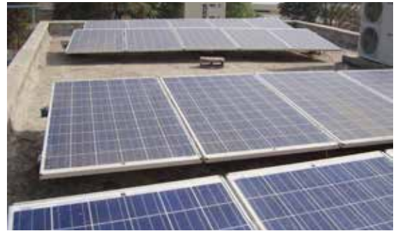
Die neue PV-Anlage auf dem Labordach
